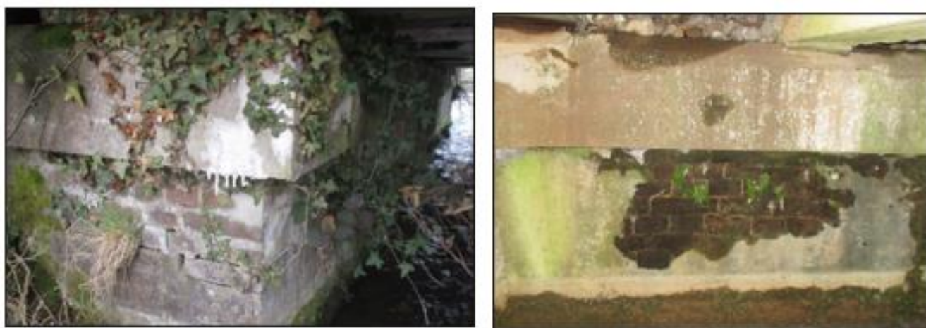
Figure 5 : Désorganisation de la chaîne d'angle Q2 et zone humide sur la culée C1
