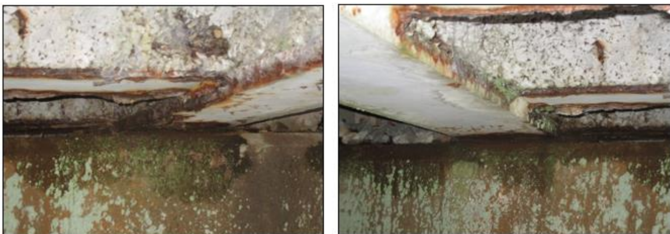
Figure 4 : Corrosion des semelles inférieures des poutres principales au droit des zones confinées
